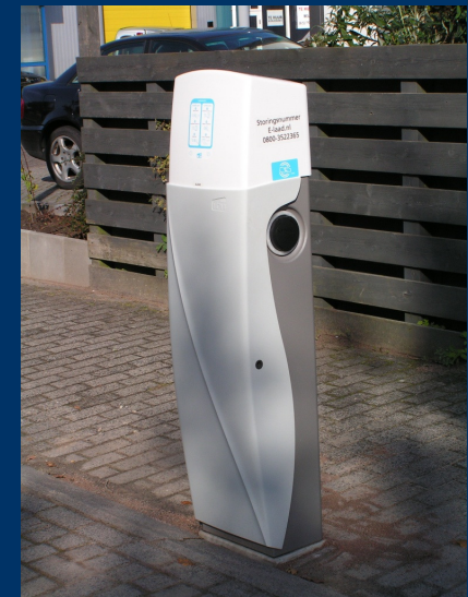
Bij het kantoor bevindt zich ook een elektrische laadpaal.
